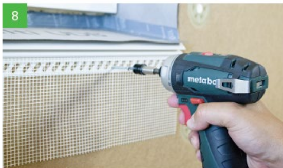
Fixation du profil goutte d'eau et du treillis d'armature sous l'appui de fenêtre à l'aide de vis ou d'agrafes en acier dans le panneau isolants.
